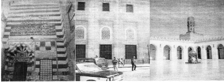
صورة رقم (٢٤، ٢٥، ٢٦) توضح أعمال الترميم الخاطئة بمسجد الحاكم ، ومسجد صرغتمش ، وزاوية أحمد بن شعبان
